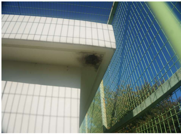
계단실 외부 배수구 설치불량
