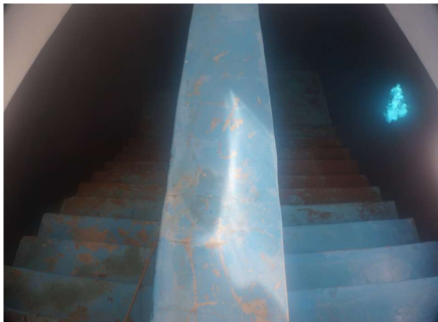
계단실 내부 하부슬래브 망상균열[모르타르]
