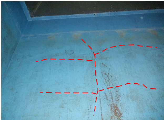
배수지2지 벽체 망상균열
