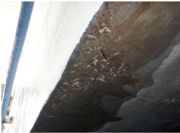
배수지1지 상부슬래브 재료분리
