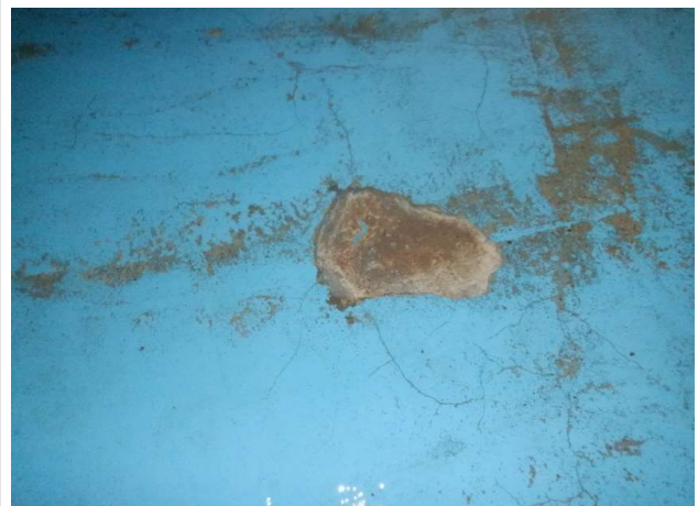
배수지2지 바닥슬래브 박리(모르타르)
