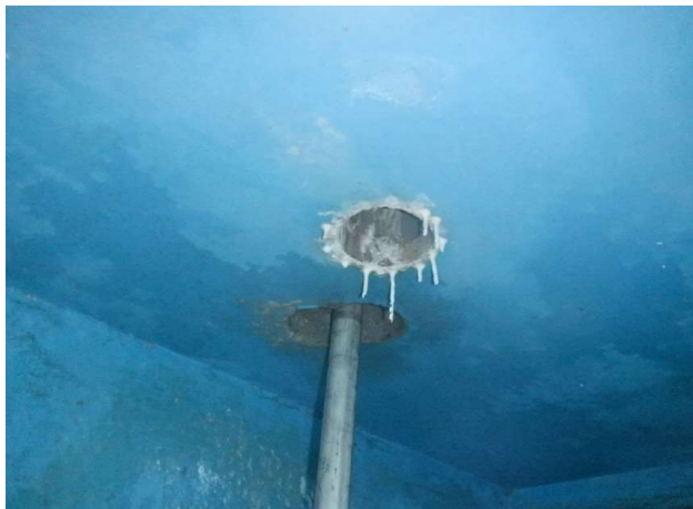
2지 유입밸브실 상부슬래브 백태
