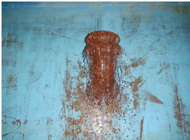
배수지 1지 유입배관 관부식/차수불량
