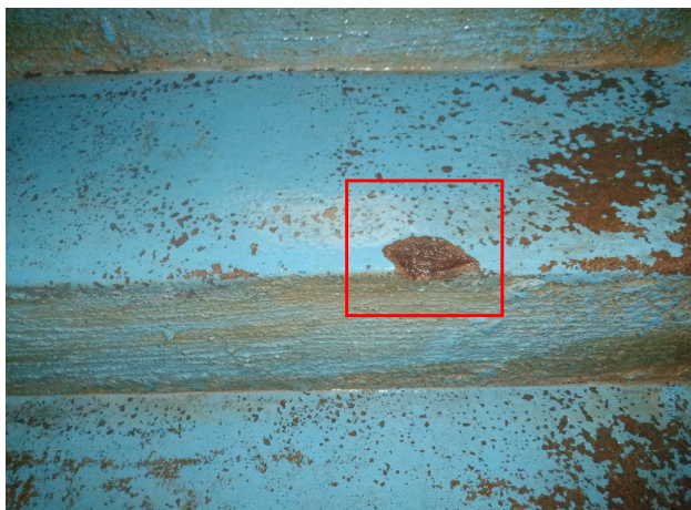
배수지2지 계단상면 파손
