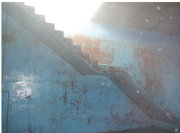
배수지 내부 안전난간 미설치
