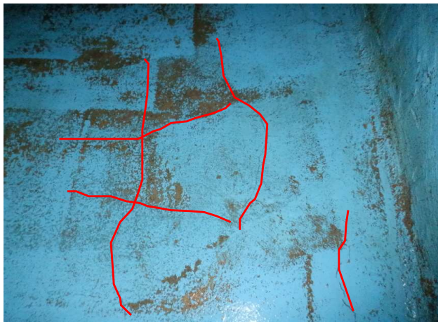
배수지1지 기둥 망상균열
