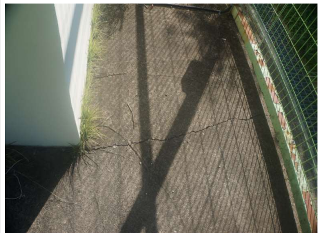
계단실 외부 바닥 균열(0.3mm이상)
