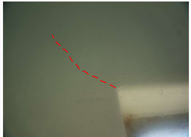
계단실 내부 벽체 균열(0.3mm미만)
