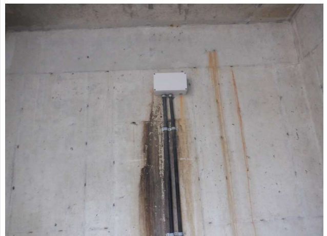
유출유량계실 벽체 누수흔적
