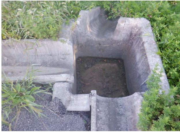
배수로 스틸그레이팅 미설치
