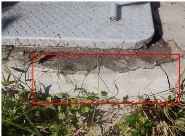
1지 유입밸브실 상부슬래브 상면 파손(모르타르)
